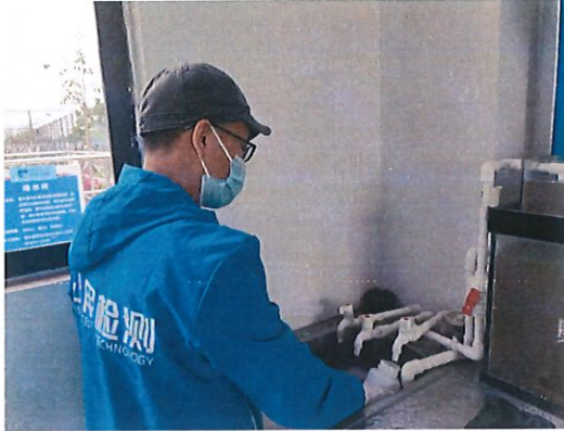
第三水厂采样口
